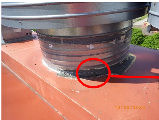
Kuva 26 IV-putkien läpivienneissä havaittiin vaurioita.
