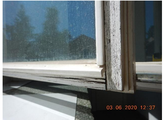
Kuva 39 Ulkopuitteiden puuosat halkeilivat ja maalipinnat hilseilivät.
