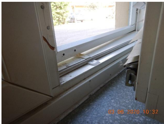
Kuva 46 Paikallisesti yhdistysheloja on rikkoutunut.
