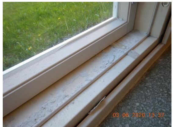
Kuva 53 Tilan 031 ikkunavälissä havaittiin vaaleahakoa, sinertävää jauhetta.
