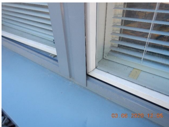
Kuva 48 Tilan 001 pohjoispuolen ikkunoiden ulkopuitteet eivät sulkeutuneet kunnolla.
