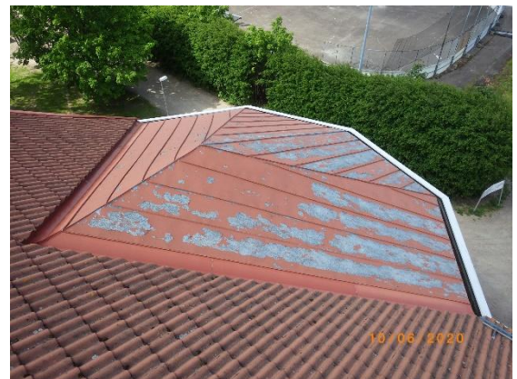
Kuva 21 Peltikatetun osan maalipinnoite irronnut merkittävästi.
