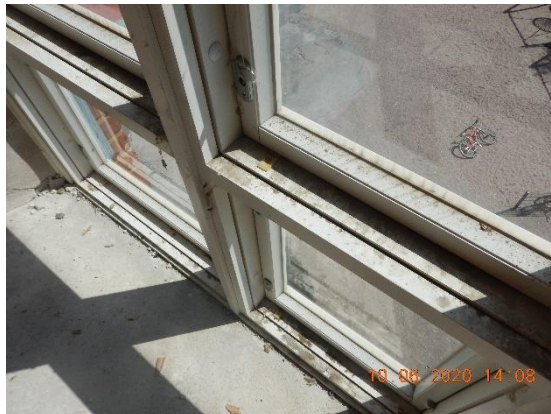
Kuva 40 Ullakon ikkunassa sisäpuite on poistettu ja ulkopuitteen tiivistyksessä havaittiin puutteita.
