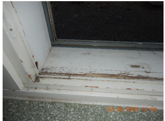
Kuva 51 Karmin puussa mekaanista kulumaa johtuen siitä, että puite hankaa karmia avattaessa.
