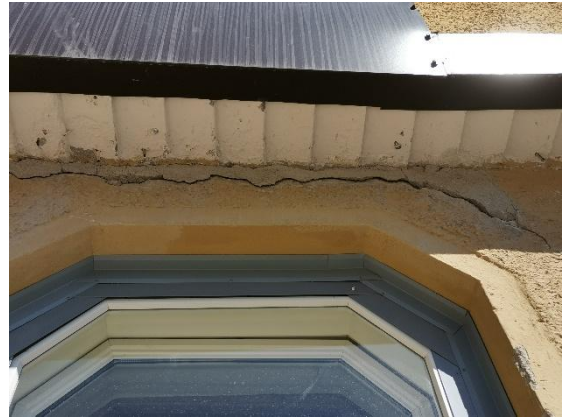
Kuva 11 Halkeama pääsisäänkäynnin vieraisen ikkunan yläpuolella.
