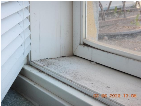
Kuva 50 Sivukarmeissa havaittiin halkeamia karmin liimasauman kohdalla.
