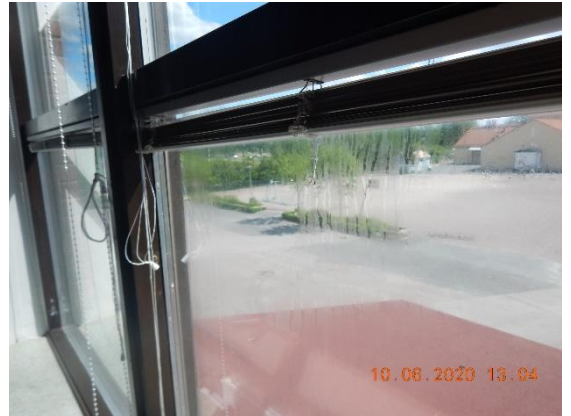
Kuva 55 Tilan 218 2-lasisen eristyslasi ikkunan lasiväli huurtuu.
