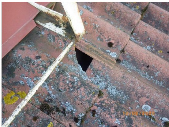
Kuva 20 Tutkimuksessa havaittiin yksittäisiä rikkiäisiä kattotiiliä.
