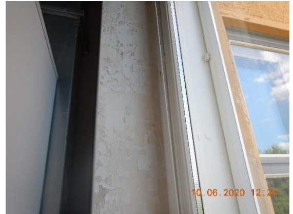
Kuva 61 Tilan 217 sisäpuolen smyygeissä maalipinta hilseili runsaasti.
