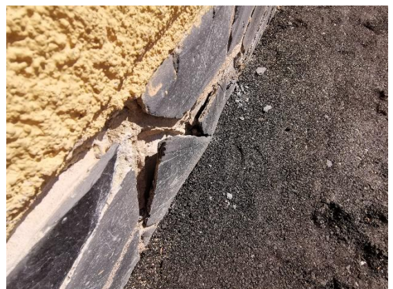
Kuva 9 Osa liuskekivilaatoista on irtoamassa tai kokonaan jo irti.
