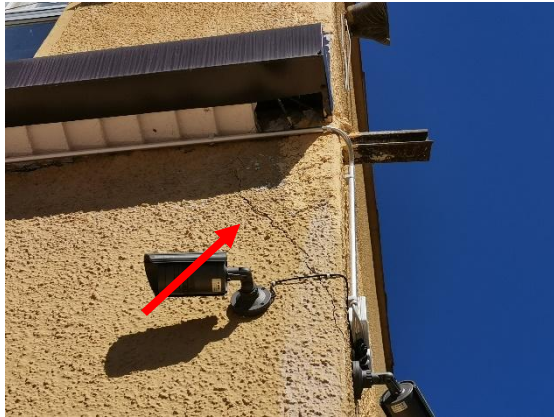
Kuva 10 Halkeama A-osan kaakkoisnurkassa.
