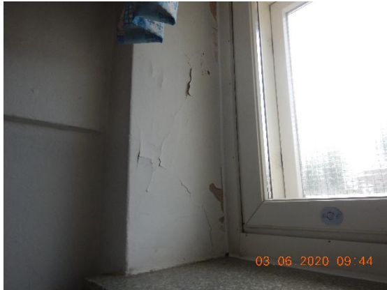
Kuva 60 Paikoin sisäpuolen smyygeissä havaittiin maalipinnan lohkeilua ja halkeilua.
