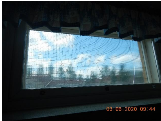
Kuva 56 Kellarin eteläpuolen turvalaseissa havaittiin halkeamia.
