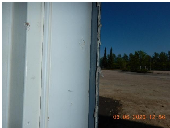
Kuva 42 Ikkunoiden ulkopuitteen tiivisteet ovat pääosin puutteelliset.
