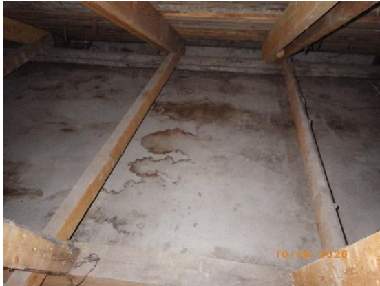
Kuva 28 Vanhoja vuotojälkiä ullakkotilassa.
