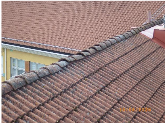
Kuva 18 Vesikatolla osa oli osa harjatiilistä asennettu huonosti.
