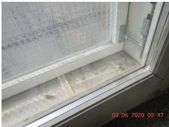
Kuva 52 Karmiväleissä havaittiin kosteusjälkiä pääosin kellarin osalla.
