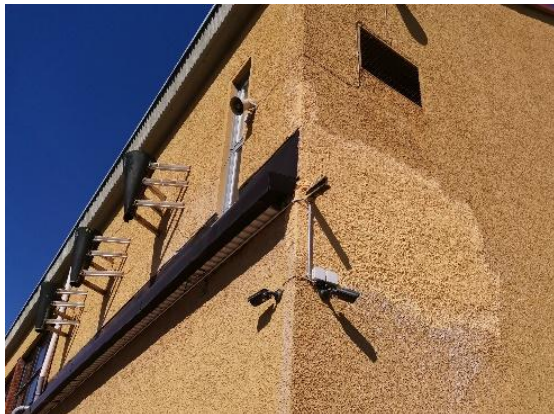
Kuva 12 Paikkakorjaus A-osan kakkoisnurkassa.
