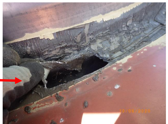
Kuva 27 IV-putkien läpivienneissä havaittiin vaurioita.
