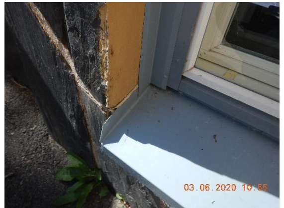
Kuva 57 Vesipeltien liittymien tiiveys ulkopuolen smyygeihin oli paikoin puutteellinen. Vesipeltien kallistukset olivat pääosin hyvät.
