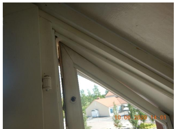
Kuva 49 Joidenkin ikkunoiden osalla ulkopuitetta ei pysty avaamaan, sillä se ottaa karmiin kiinni.
