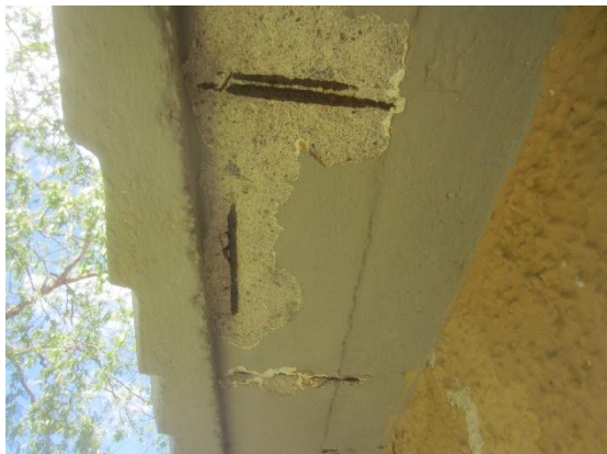
Kuva 36 Teräskorroosion aiheuttamia vaurioita räystäässä.
