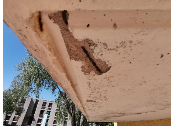
Kuva 15 Teräskorroosion aiheuttamia vaurioita lipassa.
