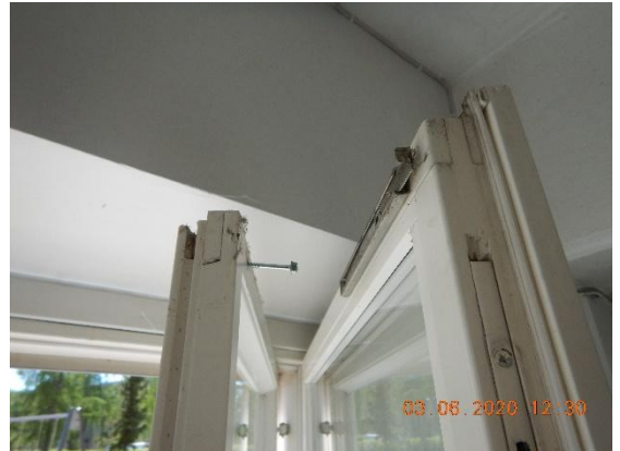
Kuva 45 Tuuletusikkunan yhdistyshela on korvattu ruuvilla.
