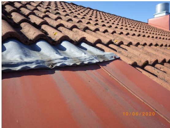
Kuva 24 Kattoluukun läpiviennin limitys tiilikatteeseen. Osa materiaaleista ovat ikääntyneitä ja limitysten tiiveys epäselvä.
