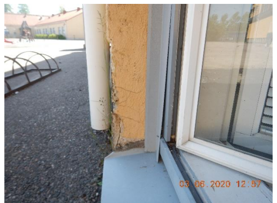
Kuva 59 Ulkopuolen smyygeissä havaittiin rappauksen halkeilua ja maalipinnan kulumaa.
