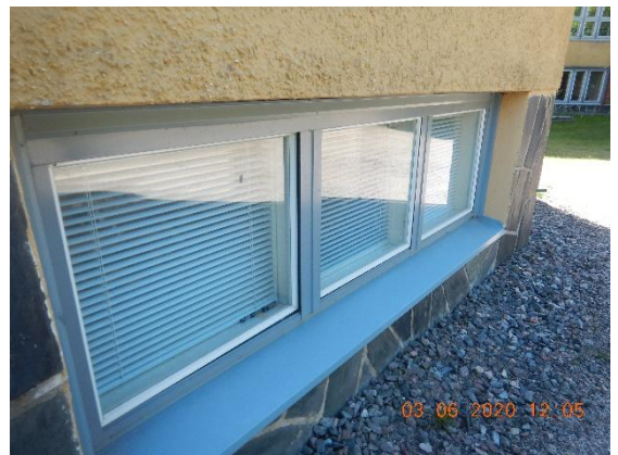
Kuva 47 Rikkoutuneiden yhdistyshelojen myötä ulkopuitetta ei saa tiiviisti suljettua. Kuvassa pohjoispuolen kellarin ikkuna.
