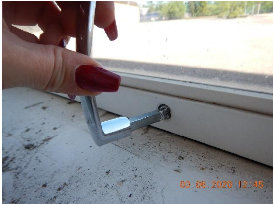
Kuva 44 Ulkopuitteen heloissa olevien muoviosien havaittiin rikkoutuvan helposti.
