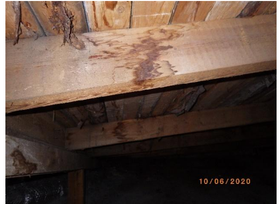
Kuva 29 Vanhoja vuotojälkiä ullakkotilassa.
