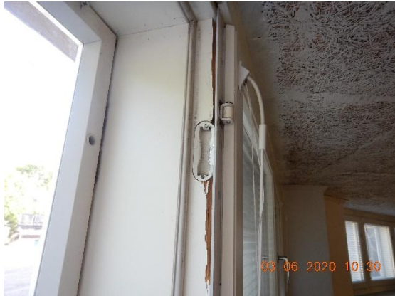
Kuva 54 Välipystykarmeissa havaittiin halkeamia ja puun lohkeamista tilassa 001.
