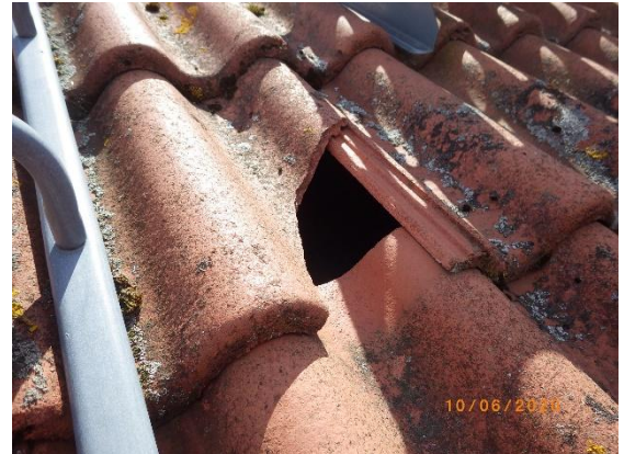
Kuva 19 Tutkimuksessa havaittiin yksittäisiä rikkiäisiä kattotiiliä.
