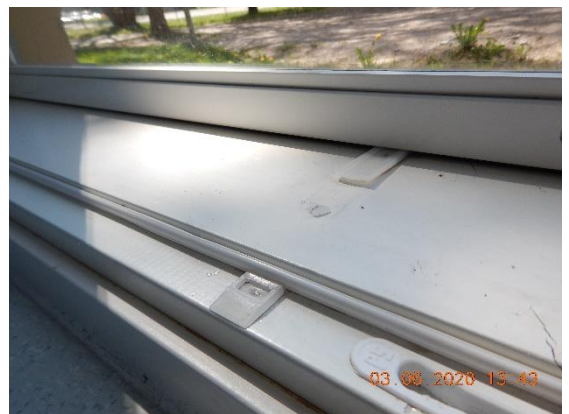
Kuva 43 Ikkunoiden muoviset puiteliu'ut ovat pääosin rikkoutuneet.
