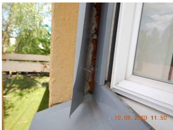
Kuva 58 Ulkopuolen suojapellit olivat vääntyneitä paikoin. Kuva tilan 214 ikkunasta.
