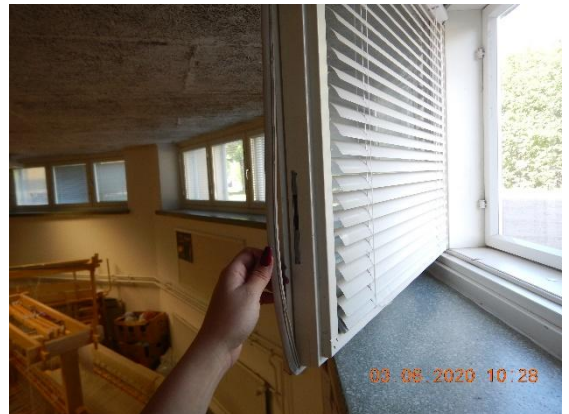
Kuva 41 Sisäpuitteen tiivisteet ovat paikoin irronneet.
