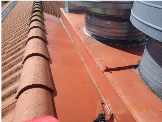
Kuva 22 Pellitettyjen läpivientien kohdalla ei ole vastakaatoja.
